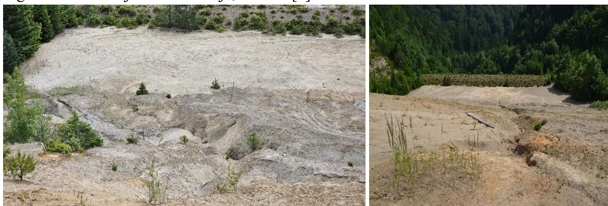
Slika 7. Erozijska na brani flotacijskog jalovišta
