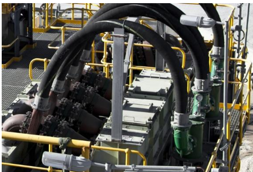
Slika 11. Pumpno postrojenje za injektiranje koncentrata
