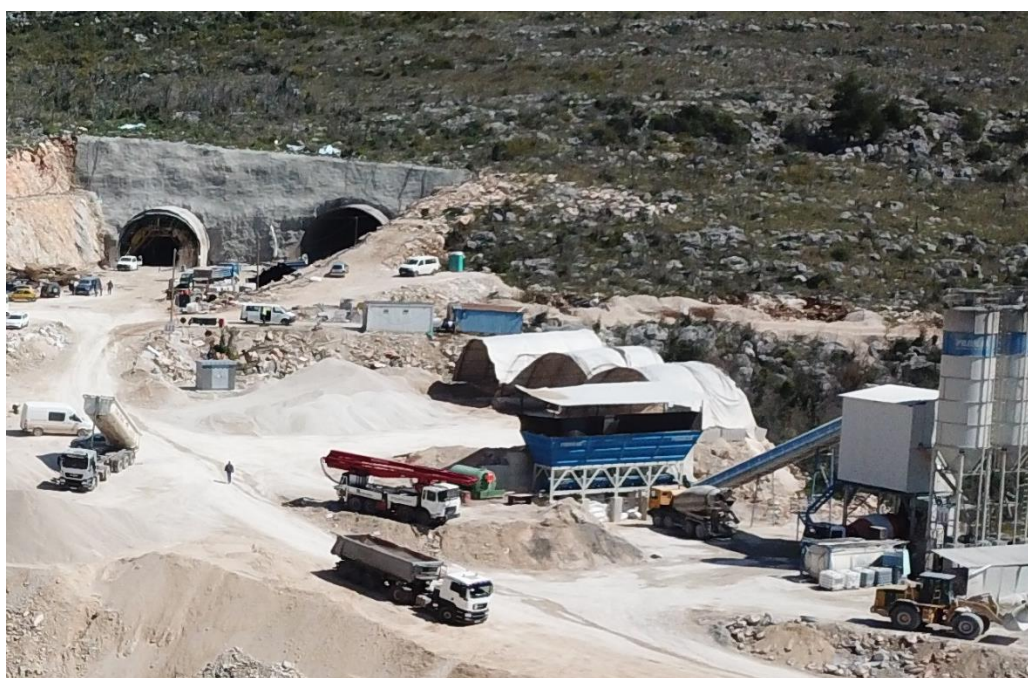
Slika 4. Izgled instalirane betonare za proizvodnju betona [6]
